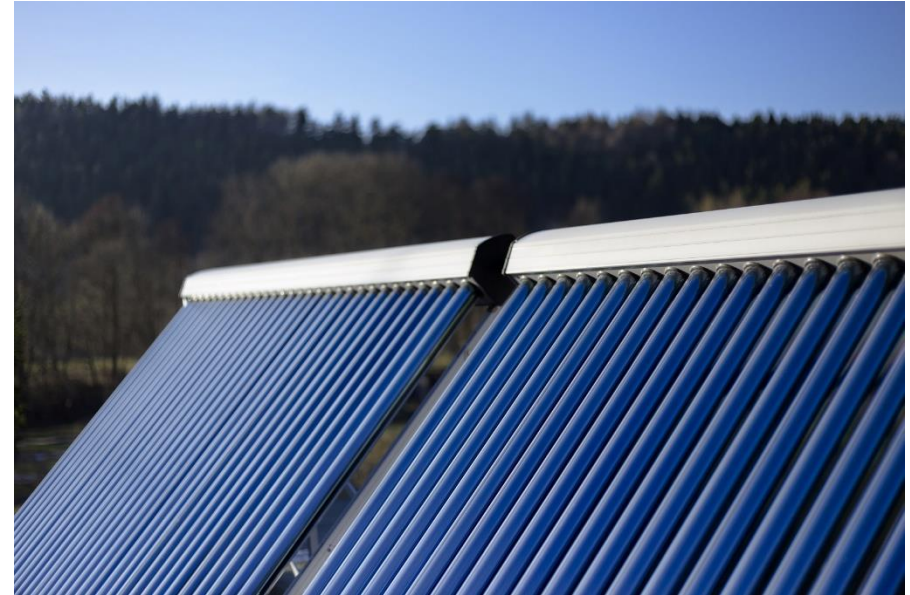
Solarthermie – hier Vakuumröhrenkollektoren
